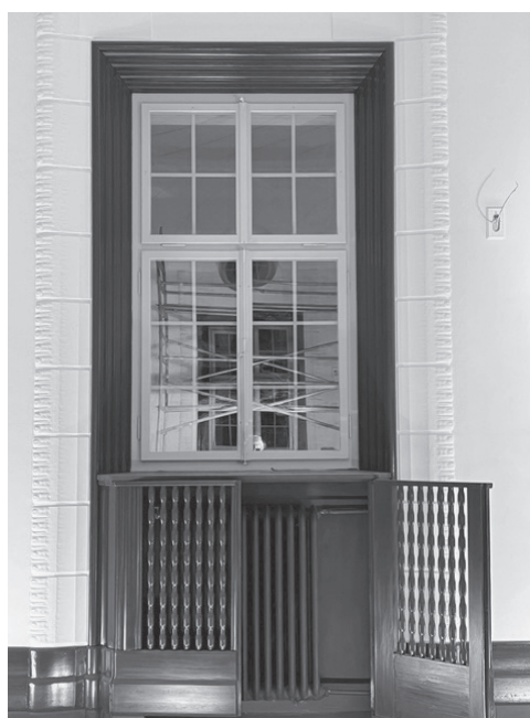
Renovierte Heizung, Foto: Gaby Demme
