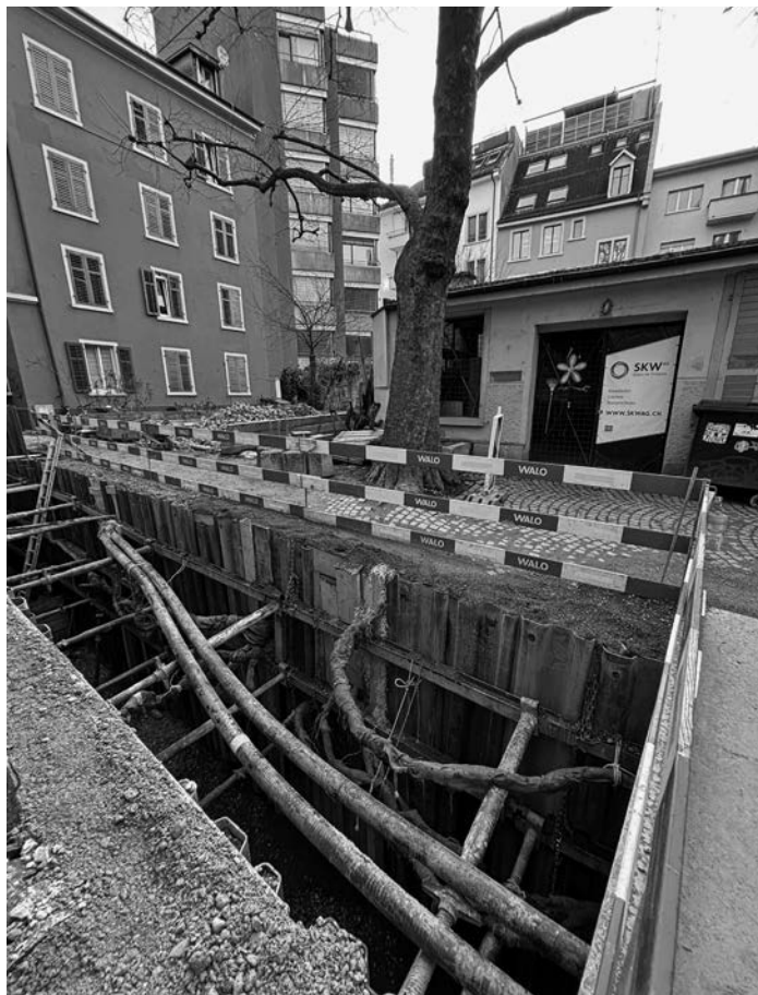
Wurzelwerk Platane, Siegfriedstrasse, Foto: Energie 360° AG, Zürich
