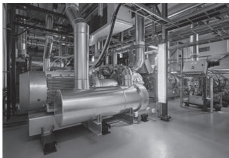
Wärme aus dem See gewinnen via Wärmepumpe in der Energiezentrale des Energieverbundes Thalwil, Foto: Energie 360°
