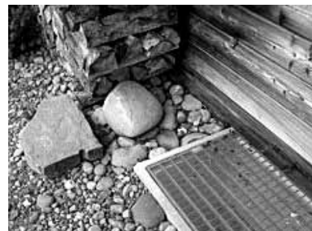
Lichtschacht: Eine potenzielle Falle
